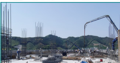
4階部分。まだ床部分のみで、柱の鉄骨部分がむき出しの状態です。
